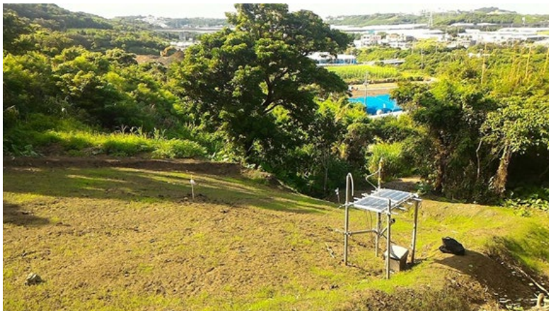
地盤変形継続監視システム
